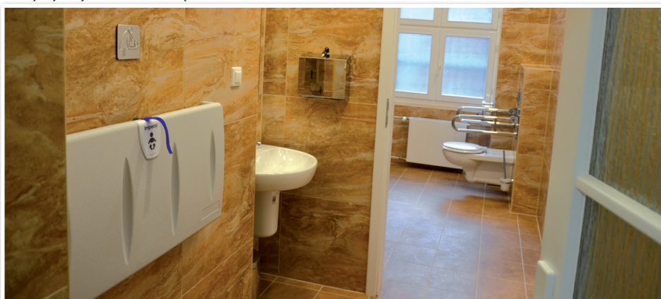
Nowa toaleta na parterze Urzędu
